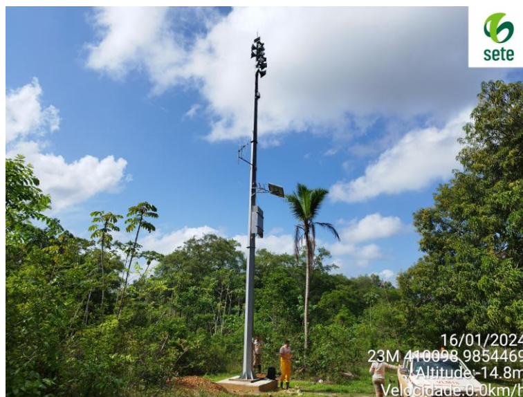
Figura 19 Estação Remota instalada
